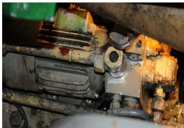
Zdjęcie nr 4. Pompa ciśnienia oleju piasty śruby nastawnej napędzana silnikiem elektrycznym
