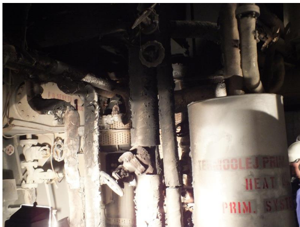
Zdjęcie nr 2. Pomieszczenie siłowni na poziomie pokładu głównego prawa burta po pożarze
