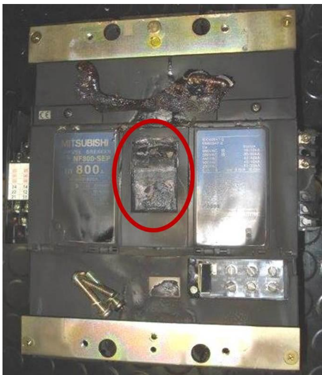
Zdjęcie nr 4. Uszkodzony wyłącznik prądnicowy nr 1 typu NF800 – SEP, Mitsubishi
