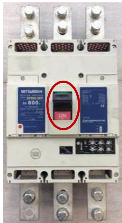
Zdjęcie nr 5. Sprawny wyłącznik typu NF800 – SEP, Mitsubishi
