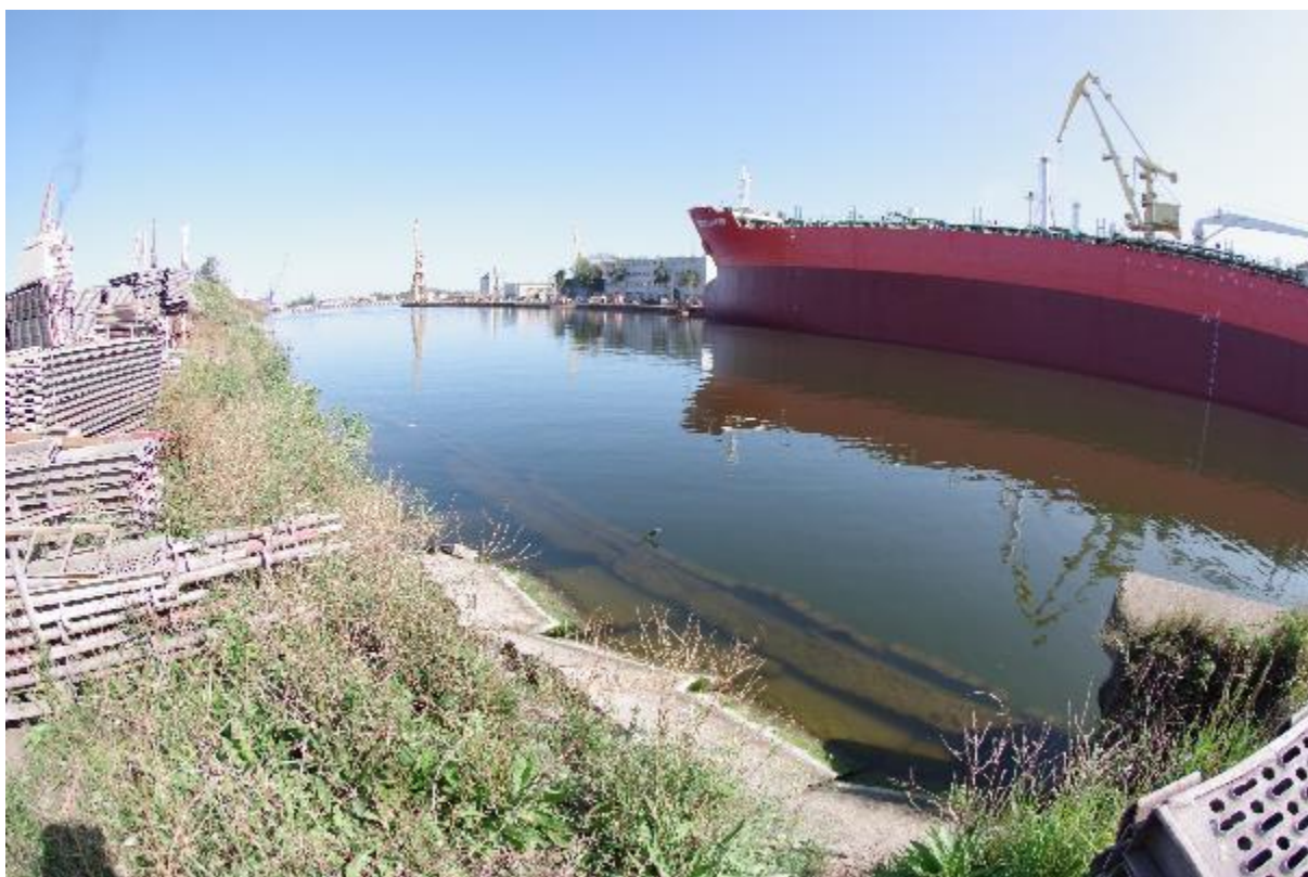
Zdjęcie 9 - Widok nabrzeża Hydrobudowy z widocznymi elementami niekontrolowanego zsuwania się elementów betonowych w nurt kanału.
