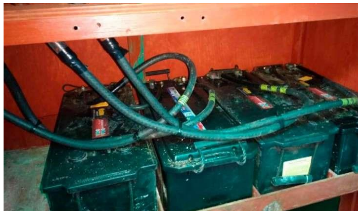
Zdjęcie nr 7 Baterie akumulatorów
