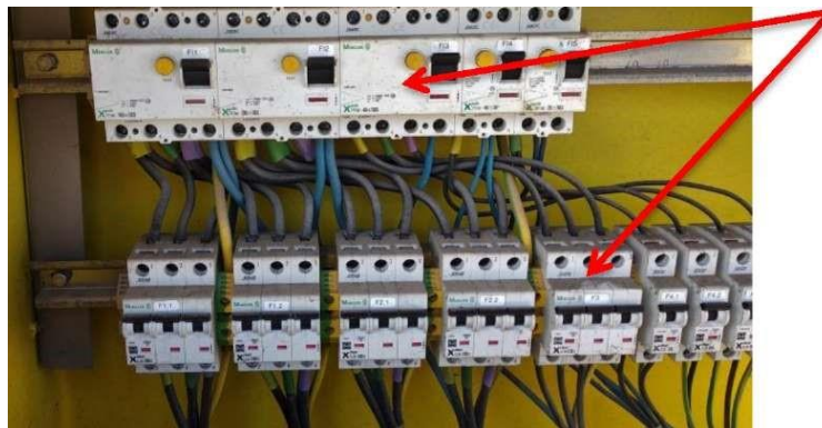
Rysunek nr 7 Zabezpieczenie obwodu gniazda 32 A zasilające kuter w dniu wypadku
