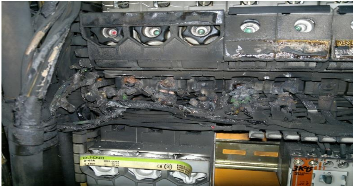
Zdjęcie nr 4. GTR - spalone obwody elektryczne w polu prądnicy G1
