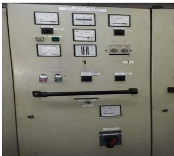
Zdjęcie nr 2. Główna tablica rozdzielcza. Pole prądnicy G1
